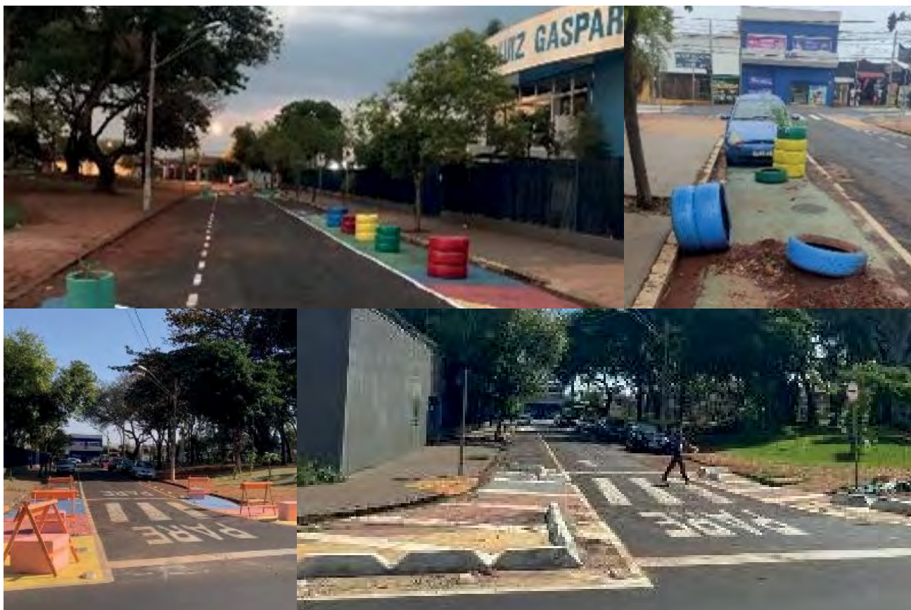
Figura H-8 | Etapa 1 da implantação concluída [acima à esquerda] e o resultado da ação de vandalismo dias após a intervenção [acima à direita]; Etapa 2 com blocos de concreto e taxas instalados paliativamente [abaixo à esquerda]; Etapa 3 com prismas instalados
